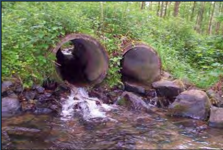
Verrohrung an einem Waldweg
