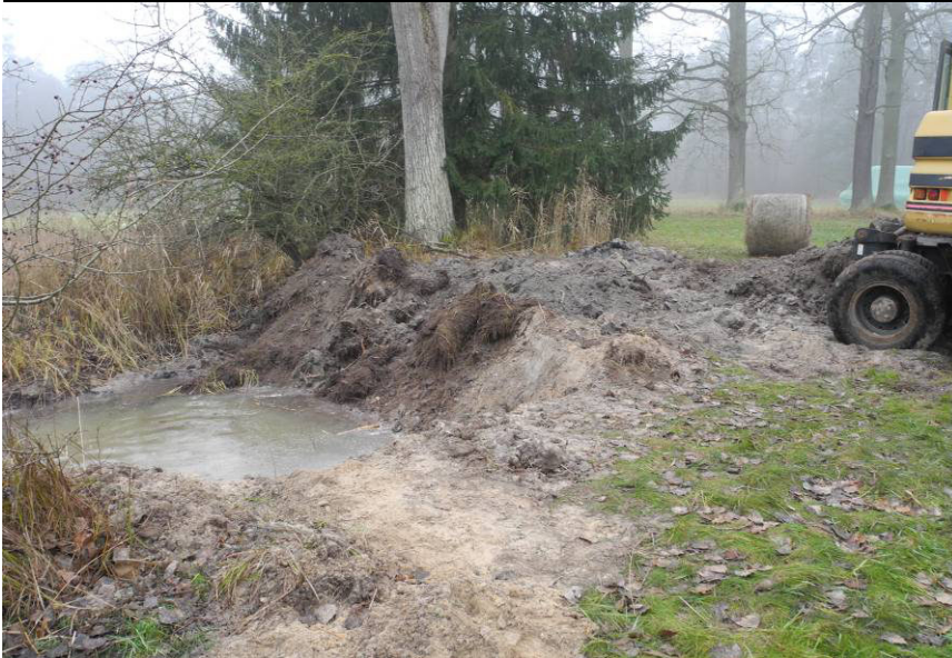
74RPK2013-Alb-NW-WL NSG Neue Wiese – Wasserlacher Hecke Verfüllung des Lochs (P. Jörms)
