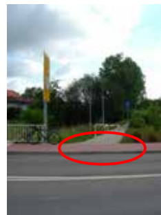
Otterbach: K 62 Beginn des Radweges in Richtung Otterberg => fehlende Bordsteinabsenkung
