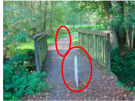
Brücke über den Frankelbach => Problem: nicht reflektierende Poller => Unfallgefahr
