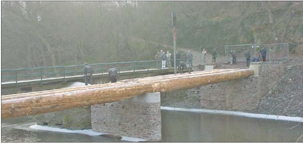
Abb. 10: Knapp 30m waren zu überbrücken, durch einen Mittelpfeiler wurde die Spannweite halbiert. Die Rundholzbalken sind als Einfeldträger verlegt. Je fünf Gebinde im Abstand von ca. 3,5m bilden die Dachkonstruktion eines Brückenabschnittes.
