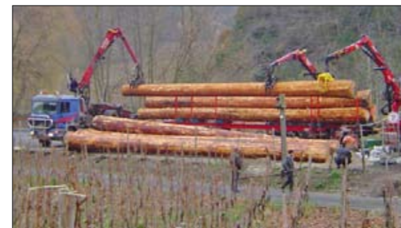
Abb. 8: Für die Montage war kein Traggerüst notwendig, die Stämme konnten mit einem Kranwagen verlegt werden.
