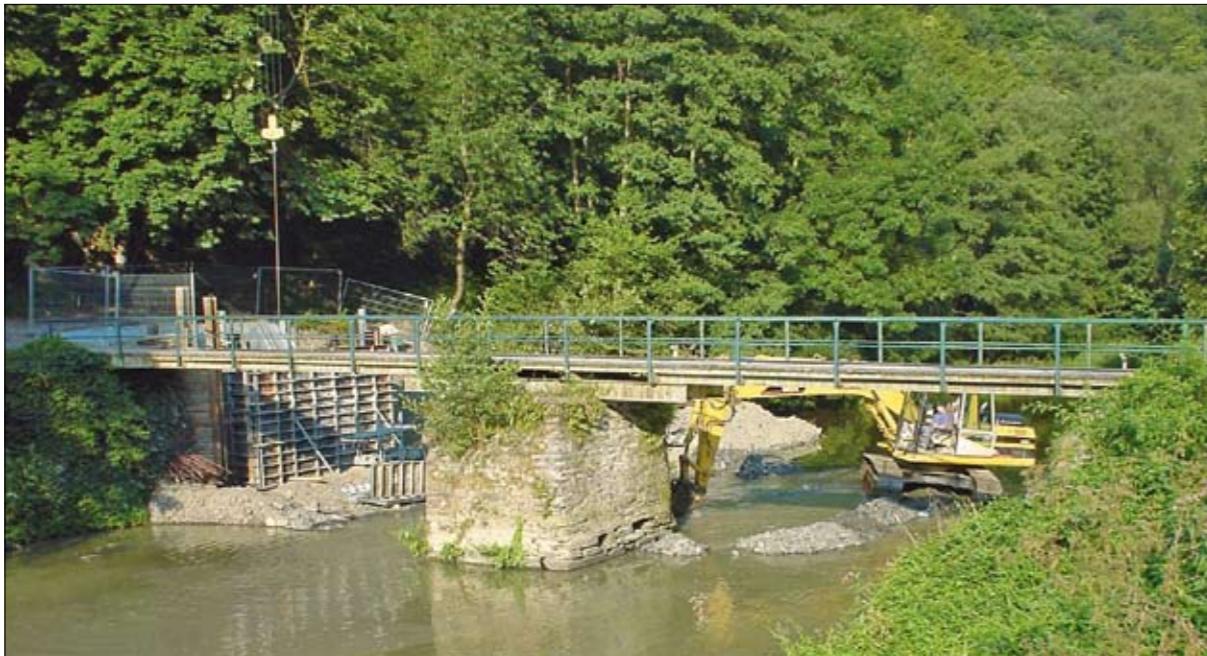
Abb. 1: Vorgefundene Situation, nicht geeignet für zukünftige Nutzungen .
