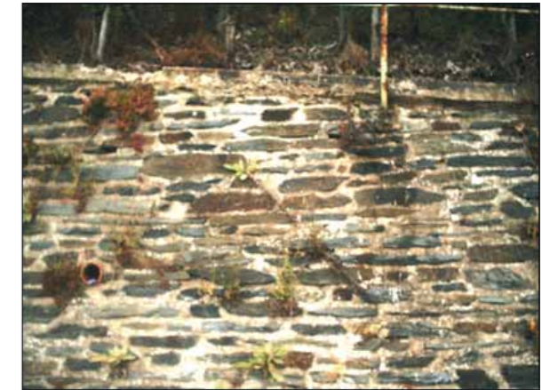
Abb. 6 und 7: Kaum besiedelte Mauerabschnitte im Verfahrensgebiet Wehlen-Sonnenuhr
