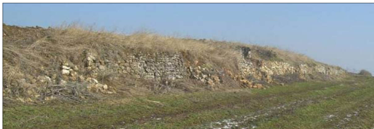
Abb. 15: Vor der Instandsetzung
