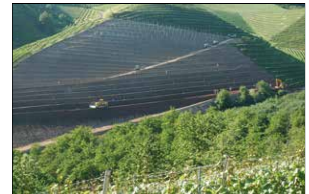
Abb. 11: Lierenbach während den Planiearbeiten: Im Hang wird die Wegeführung geändert, damit von den Querterrassen direkt auf den schräg verlaufenden Weg gefahren werden kann.
