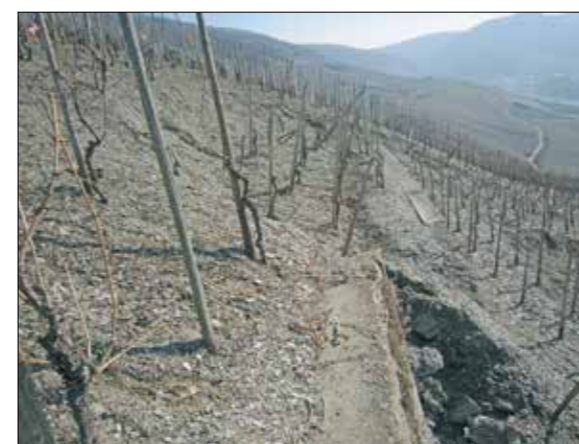
Abb. 2: Aus dem Bereich des Rutschareals mit Mauer und Abrisskante
