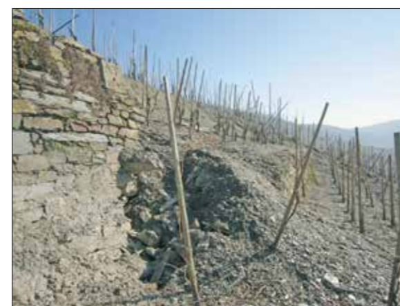
Abb. 3: Aus dem Bereich des Rutschareals mit Mauer und Abrisskante
