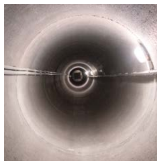
Innenansicht eines Erdkollektors zur Außenluftversorgung am Umwelt-Campus Birkenfeld
