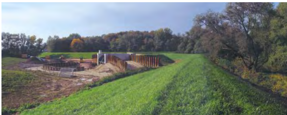
Abb. 4-56 Ein- und Auslassbauwerk am Polder „Insel Flotzgrün“. Bild: SGD Süd RLP
