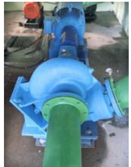
KSB Pumpe als Turbine (Brasilien) (Foto: KSB AG, Dr. Brodersen)
