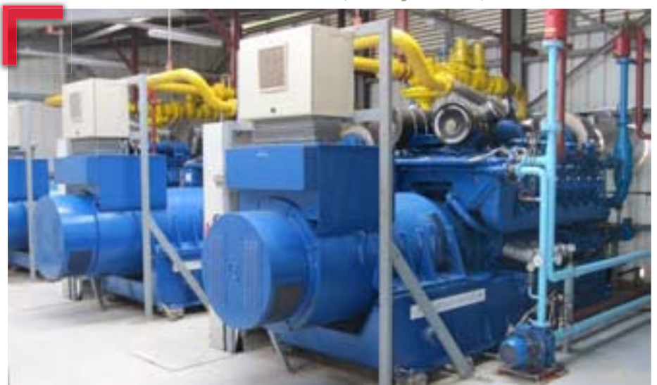
Maschinenraum am Kivu-Seeufer: Generatoren produzieren aus Methan elektrische Energie. (Foto: Margarete Bendix)
