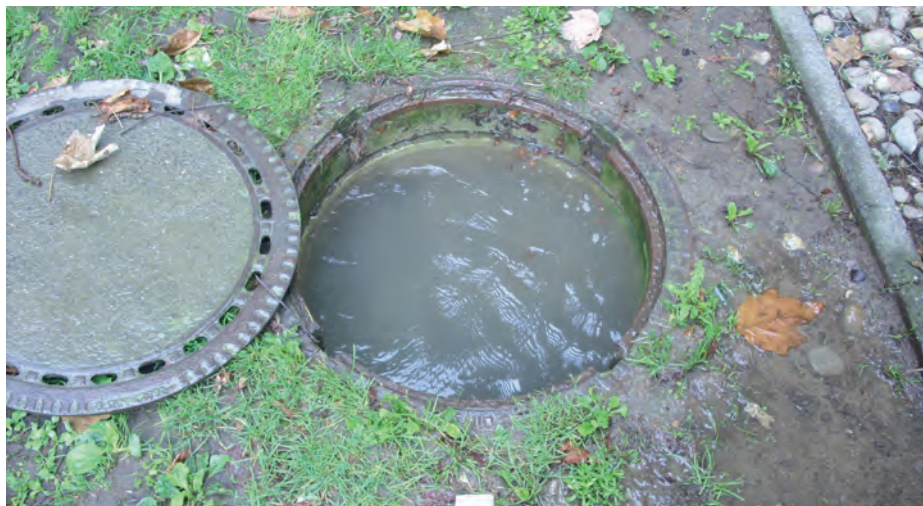
Abb. 12: gefüllter Revisionsschacht neben der RUS
