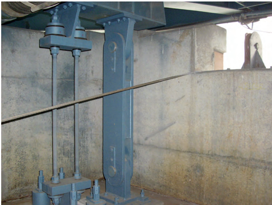
Abb. 5: Aus der Führung gesprungenes Hebeseil und alte Umlenkrolle
