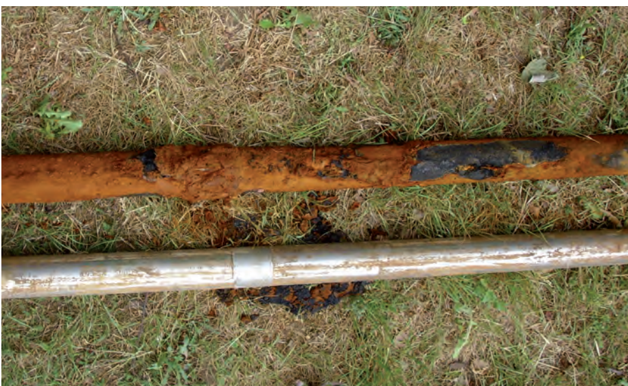
Abb. 20: korrodiertes Ableitungsrohr (oben), Ersatzrohr (unten)
