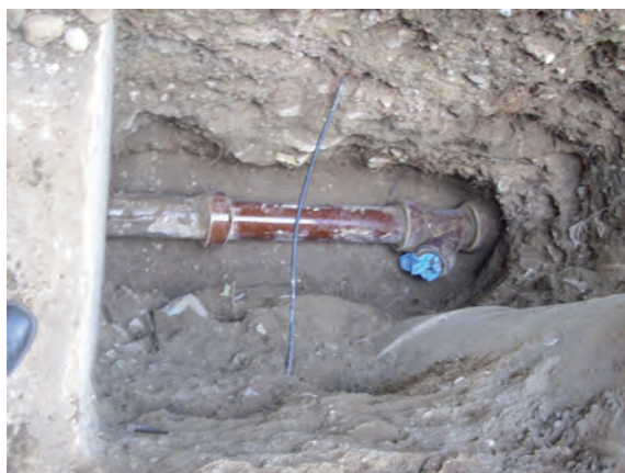
Abb. 17: offener Abzweig (provisorisch verschlossen) Zustand vor Sanierung
