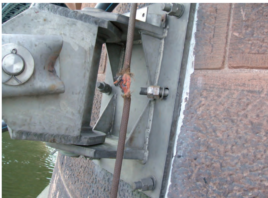
Abb. 9: Partiiell durchtrennte elektrische Zuleitung zu Pumpe 4
