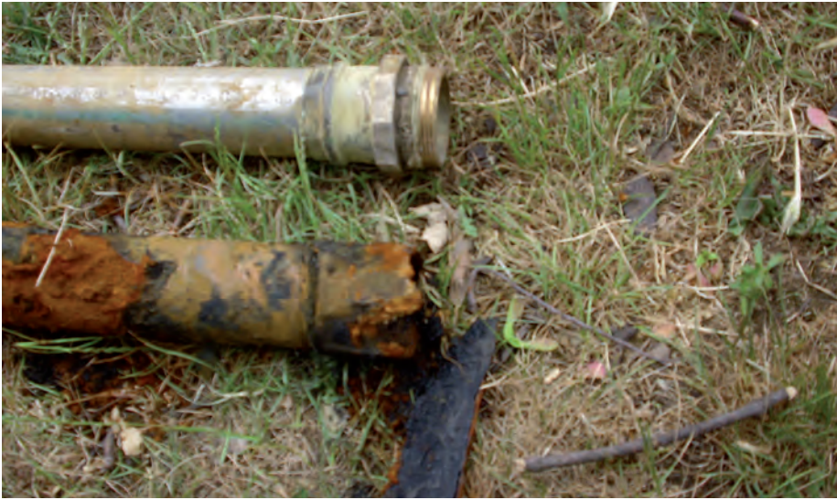
Abb. 19: korrodiertes Übergang zwischen Pumpe und Weiterleitungsrohr (unten), Ersatzrohr (oben)
