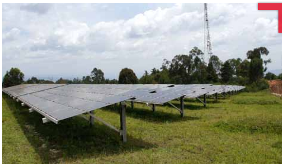
Solaranlage der Stadtwerke Mainz in Kigali (Foto: V. Wilhelmi).
