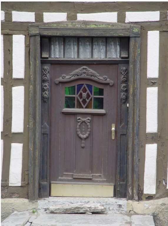
Foto der Eingangstür des Hauses Nr. 63 an der Straße, 26. Oktober 2003
