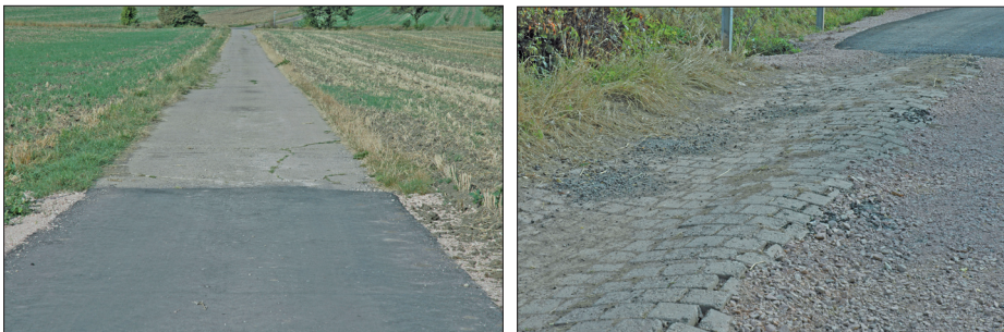
Abbildung 8: Schäden an Asphalt- und Pflasterwegen
