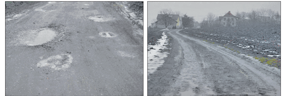
Abbildung 9: Schotterwege und Schadbilder
