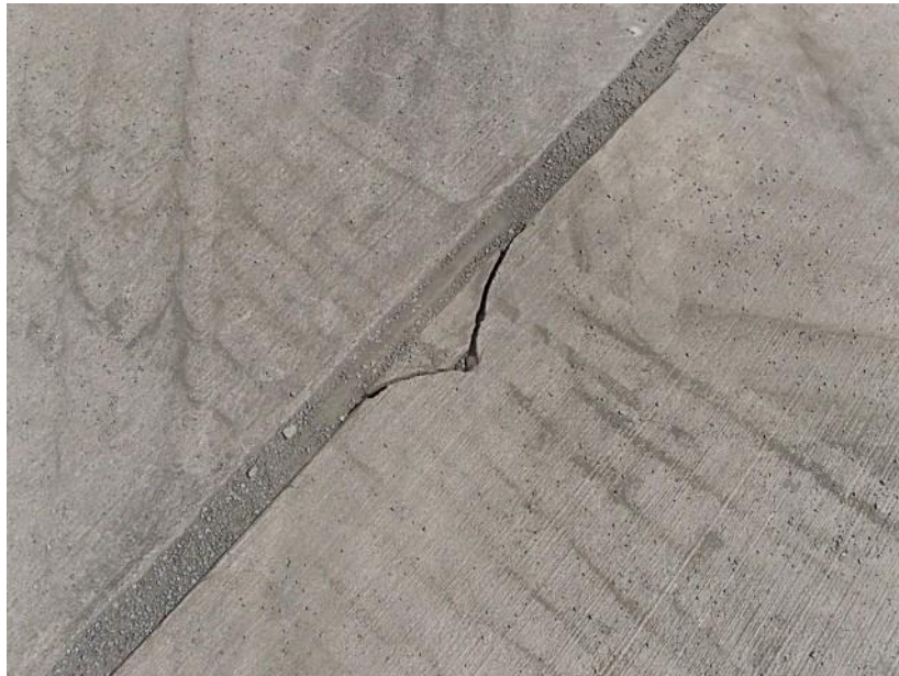
Abbildung 5 – Kantenabplatzung im Fugenbereich
