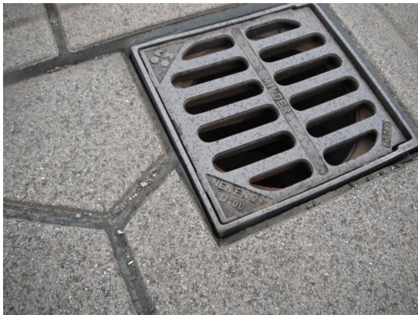
Abbildung 1 – Schadhafte Fuge am Straßenablauf
