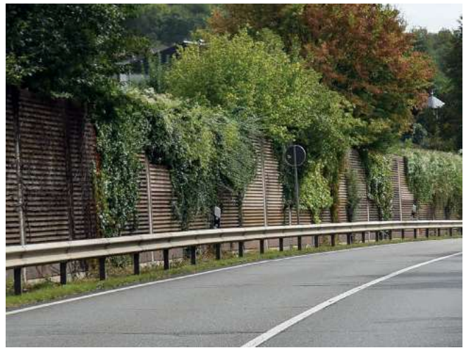
Abb. 10.6 – Hochabsorbierende Lärmschutzwand aus Beton mit Berankung an der B 42 bei Bad Hönningen
