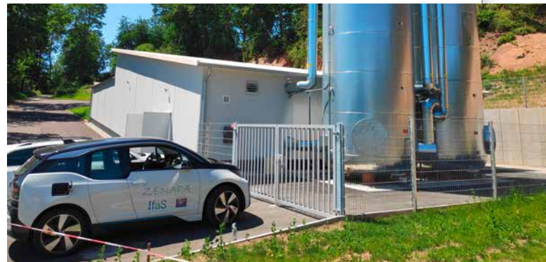
Heizzentrale mit Pufferspeicher
