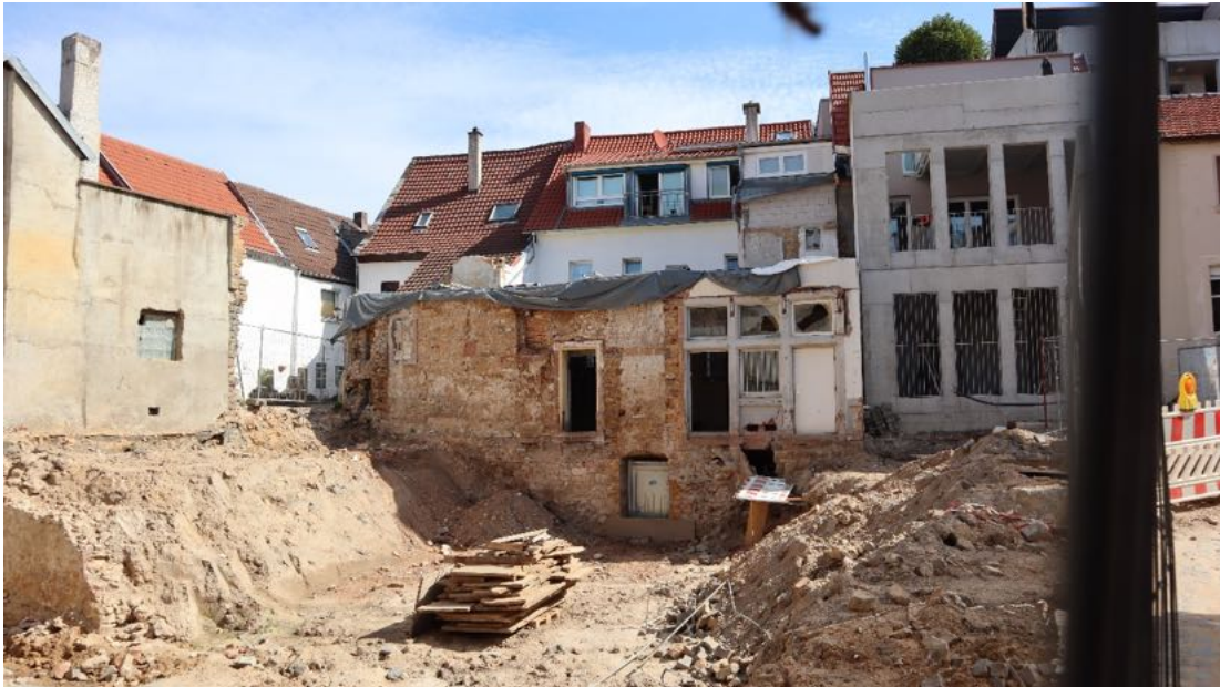
Abb. 67: Schulgasse, Blick auf die Baustelle der abgebrochenen Häuser 2 & 4 sowie ein Nebengebäude mit Kreuzgewölbestall, rechts der Neubau Haus Kirchgasse 1.
