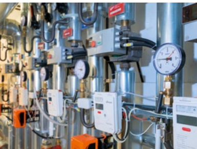
Heizungsverteiler mit Wärmemengemesser
